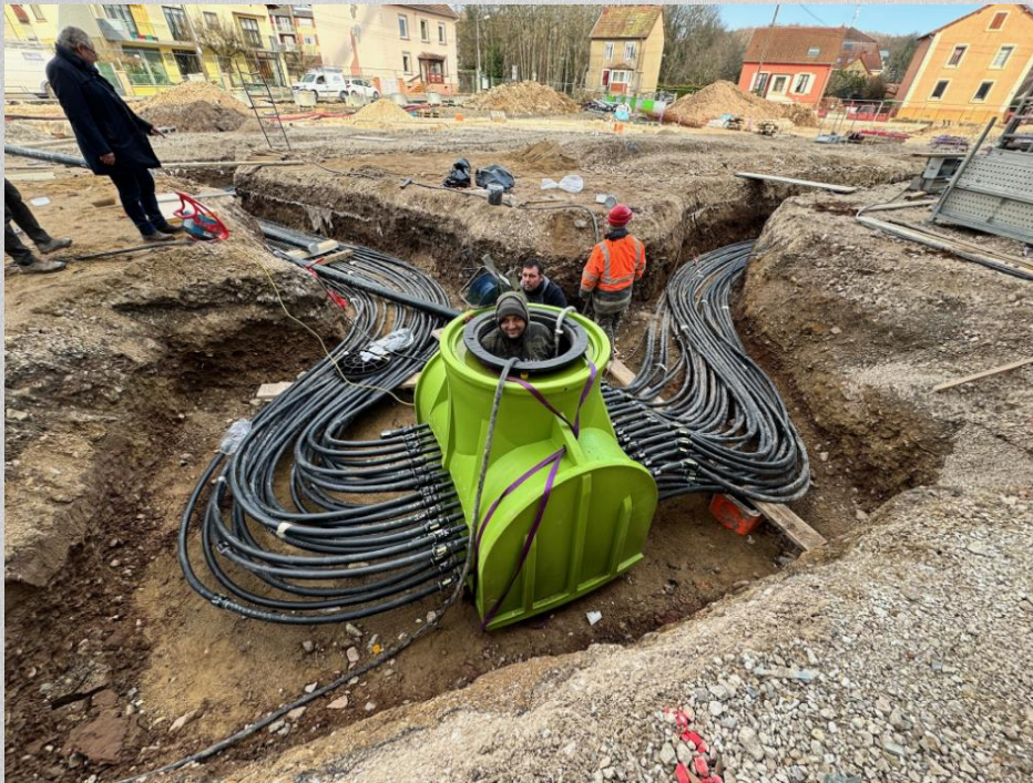
Collecteur réseau de géothermie
